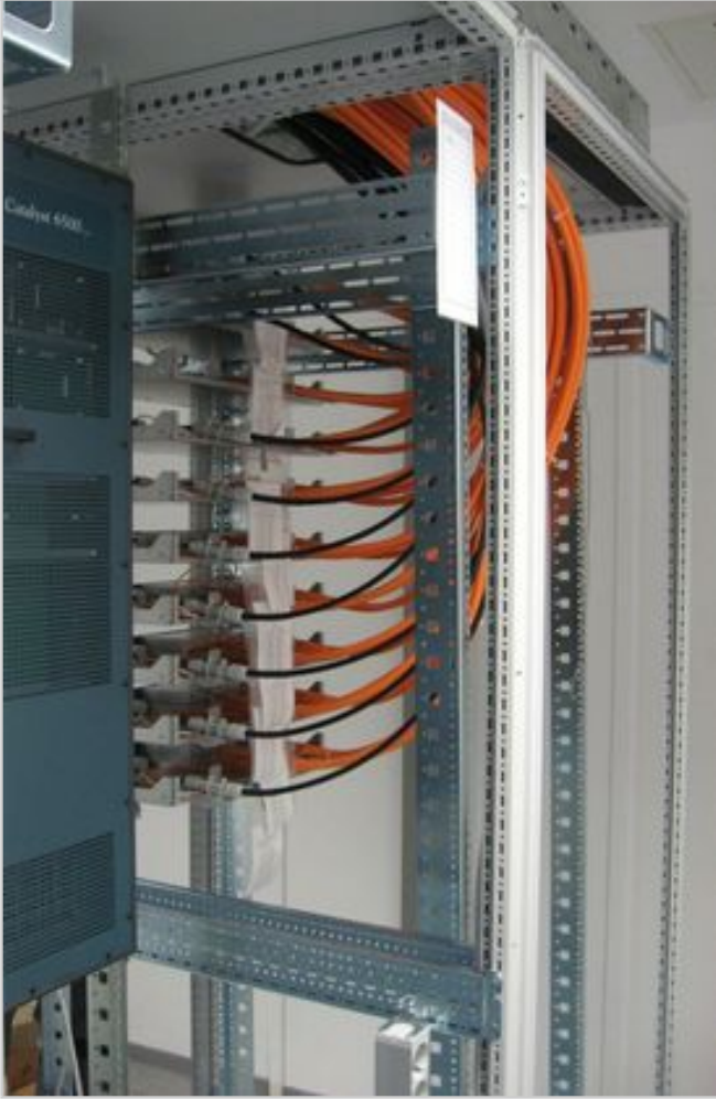
Kabeleinführung LWL und Cu, Rückseite
