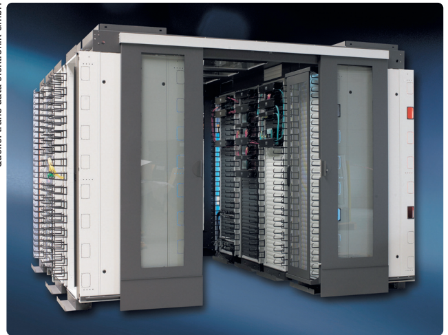
Im RZ lassen sich 35 Prozent der Energie einsparen, wenn auf Energiesparen optimierte Produkte – zum Beispiel Kabelsysteme – zum Einsatz kommen.
