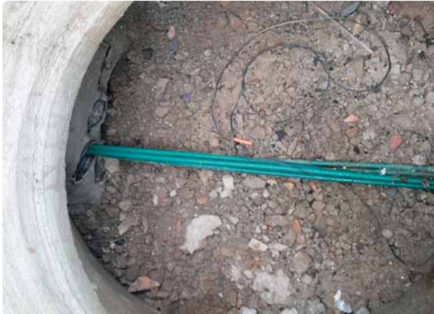
Campusverkabelung bei Rhenus Logistics: Ein Blick unter die Erde
