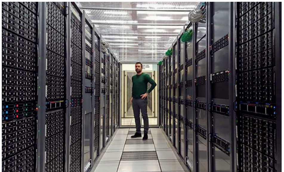
Stefano Meroli, verantwortlicher Mitarbeiter für die Installation der neuen Lösung im CERN.
